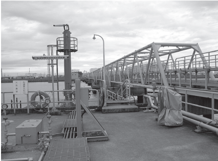
千葉港頭のバース。建設中の新1号バースで施工不良が発覚した
